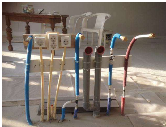
Afbeelding toont de gewenste ordelijke installatiewijze van het leidingwerk (let op: het benodigde leidingwerk is situatieafhankelijk)
